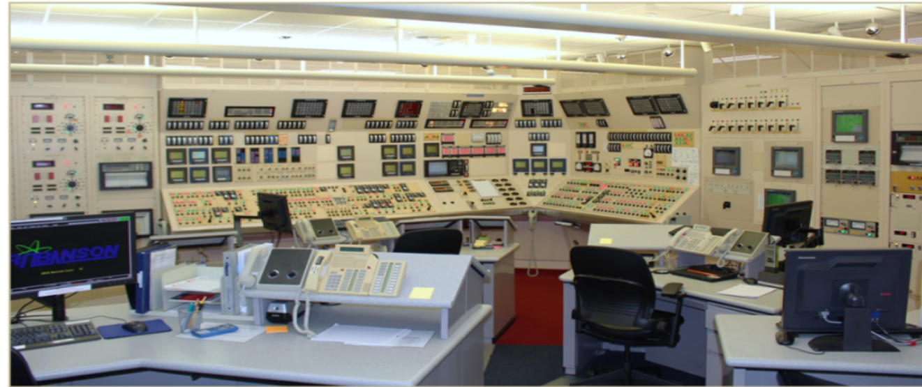
Actual Control Room Panel
